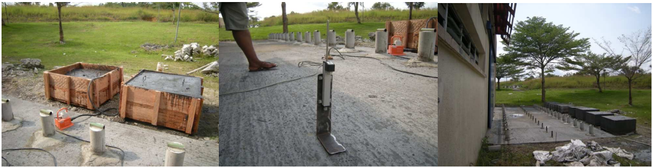
a. Coffrage et coulage des blocs b. Fixation des plots et supports de capteurs c. Vue d'ensemble
