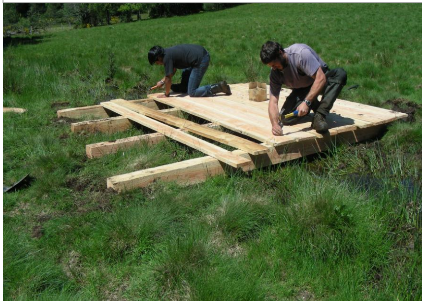
Photographie 46 : Une passerelle en bois en construction sur un ruisseau, CREN Limousin 2010
