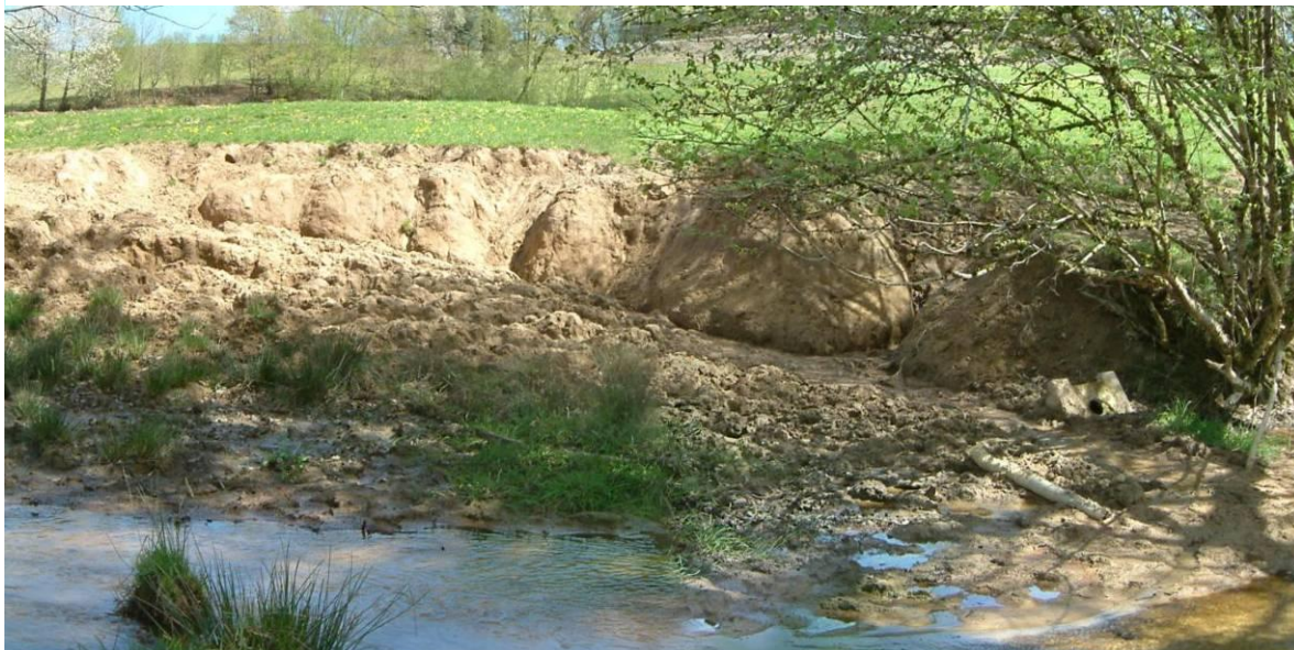
Photographie 32 : Érosions sur un affluent du ruisseau du Mazet ; clichés : N. Lhéritier, 2009
