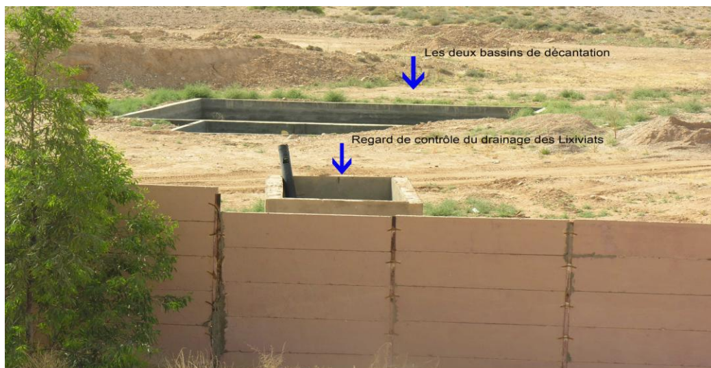
Figure 40 : Regard de contrôle du drainage des lixiviats et les deux bassins de décantation CET d'El.Outaya
