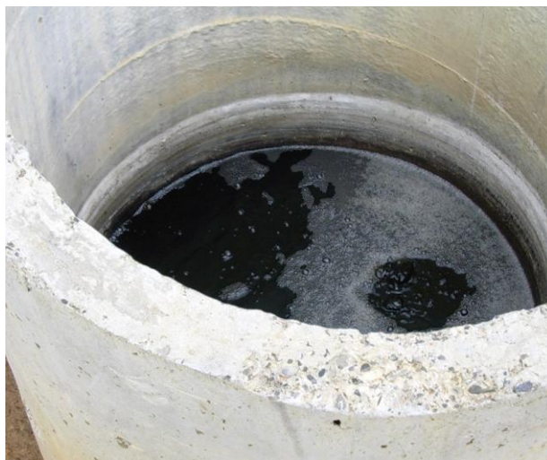
Figure 32: Remontée des lixiviats par les puits d'évacuation des biogaz au niveau du casier 1 fermé CET d'Ouled Fayet (Année 2007).
