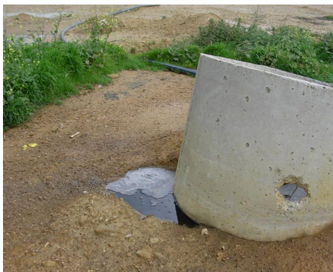
Figure 33: Remontée des lixiviats par les puits d'évacuation des biogaz au niveau du casier 2 fermé CET d'Ouled Fayet (Année 2007).
