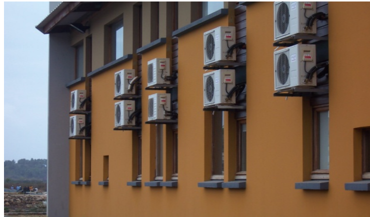
Photographie 30 : Climatisation d'un bâtiment public à Mayotte
