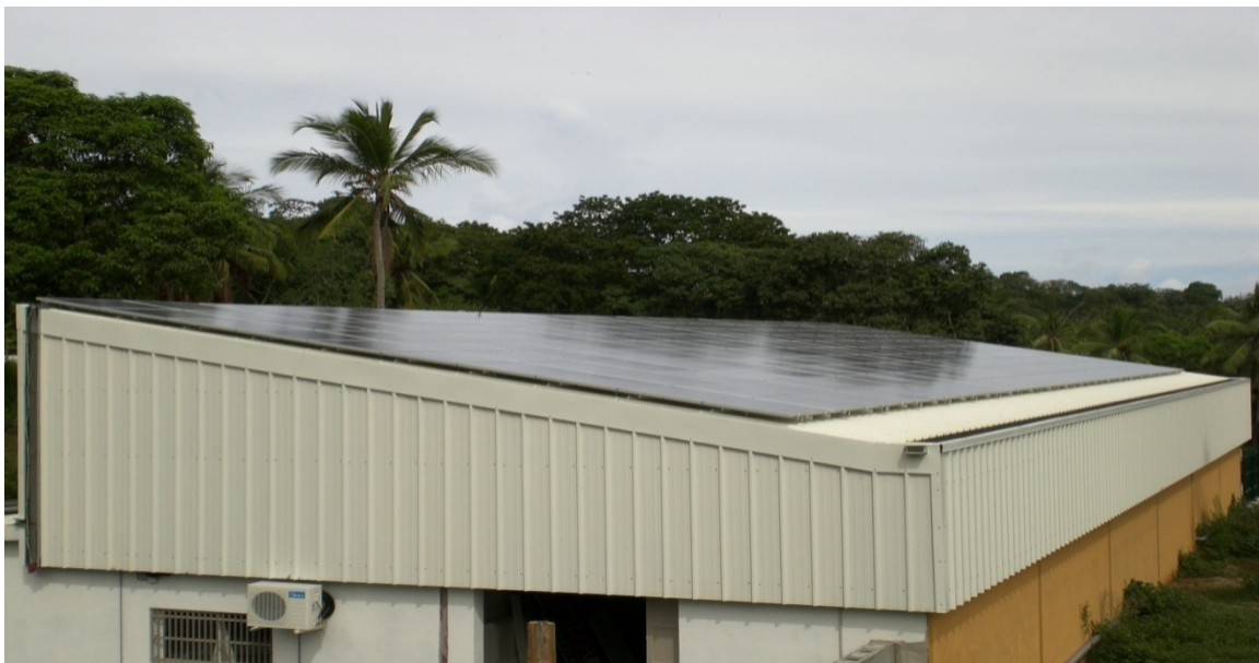
Photographie 54 : Première installation photovoltaïque privée raccordée au réseau à Mayotte
