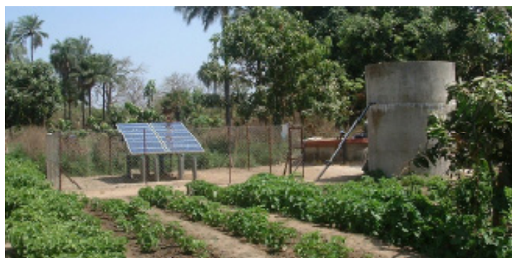
Photographie 45 : Pompage solaire d'eau dans une région agricole d'Afrique
