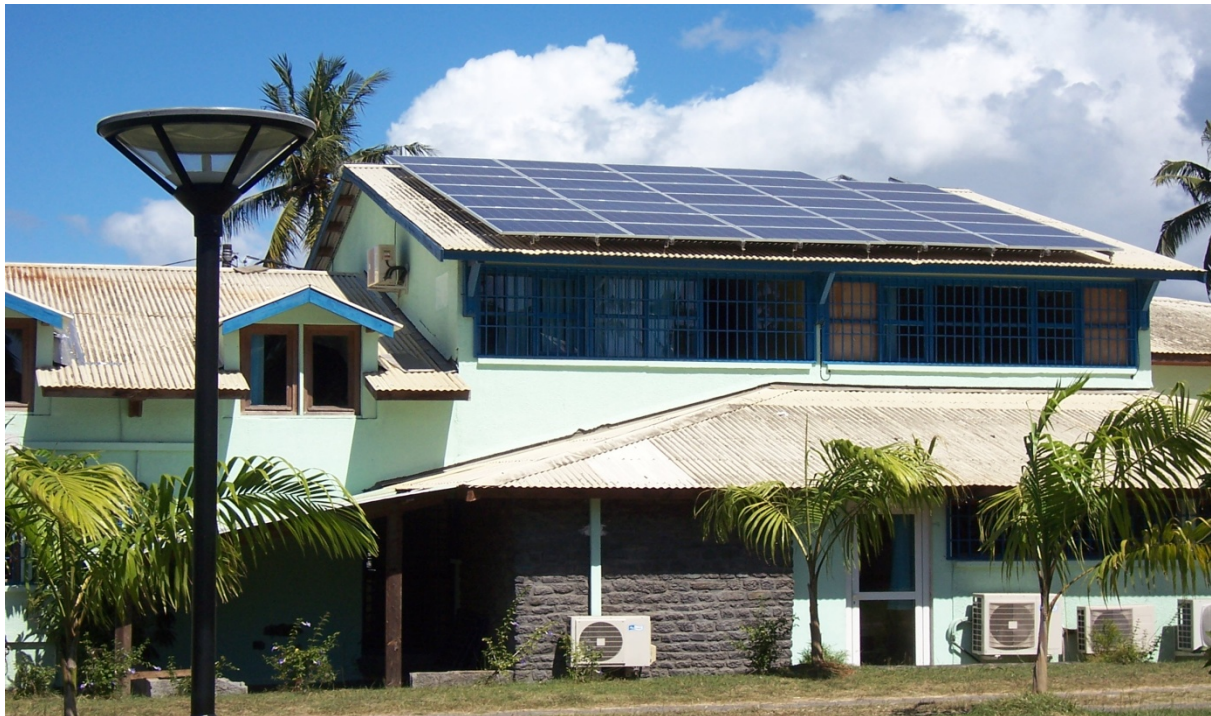
Photographie 55 : Installation photovoltaïque de 30 m 2 de superficie : 10 tonnes de CO 2 évités par an – bâtiment de la Direction de l'Environnement de Mayotte
