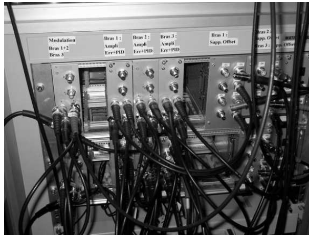
FIG. 5.23 – Photographie du rack contenant toute l'électronique des trois asservissements.
