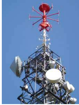
figure I.1. Exemple d'antennes pour faisceaux hertziens
