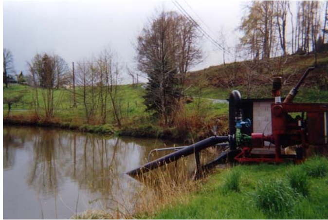
Photographie 57 : Pompe sur l'étang de Sarette à Beyssenac (19).
