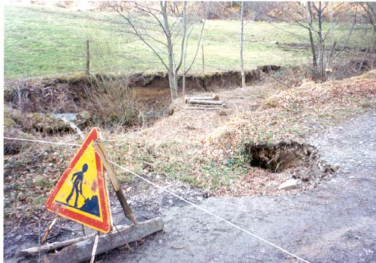
Photographie 76 : Digue détruite suite à la chute d'un arbre lors de la tempête du 26 décembre 1999 (Sardent, 23).
