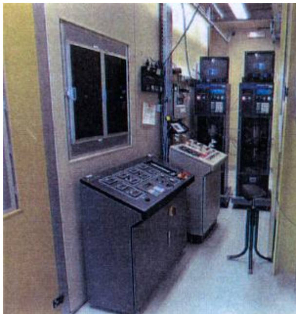
Figure 13 : Aperçu du centre de contrôle de l’installation de projection du C.E.A. Pierrelatte
