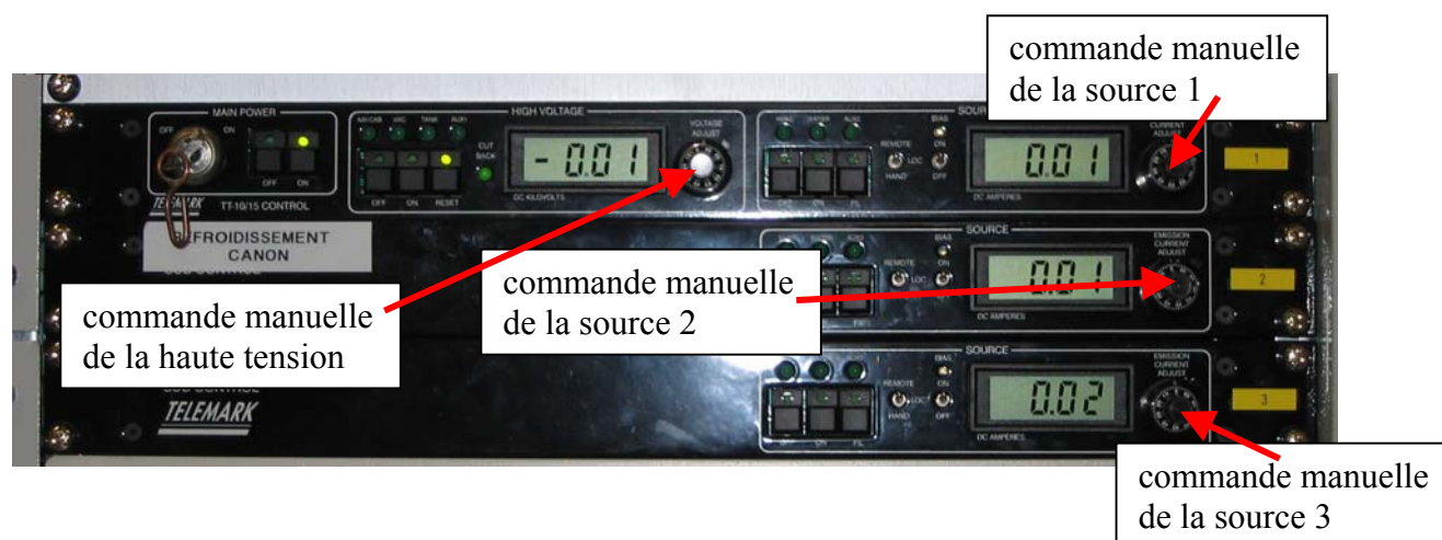
Figure 10 : Panneau de contrôle de la tension et de la puissance des blocs canons
